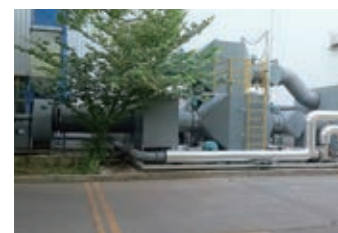
上海工場 VOC処理装置
