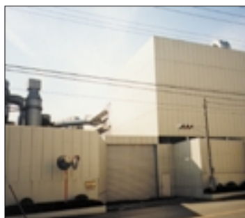
騒音対策遮音壁
