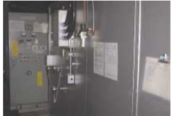
実験場内の脱臭装置
