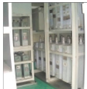
PCB保管状況
