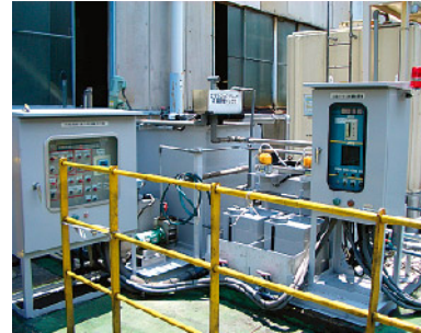
相模工場 廃液処理施設
