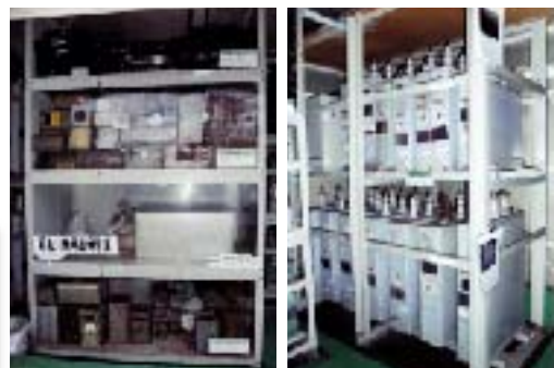
PCB廃棄物の保管状態
