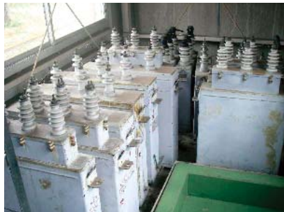
相模工場の高圧コンデンサー保管状況
