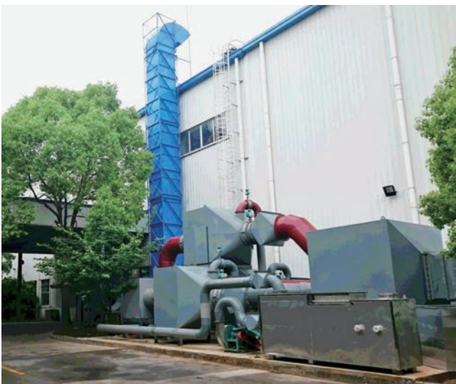
上海工場 VOC 除去設備
