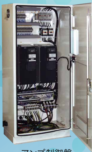
アンプ制御盤 Electrical cabinet
