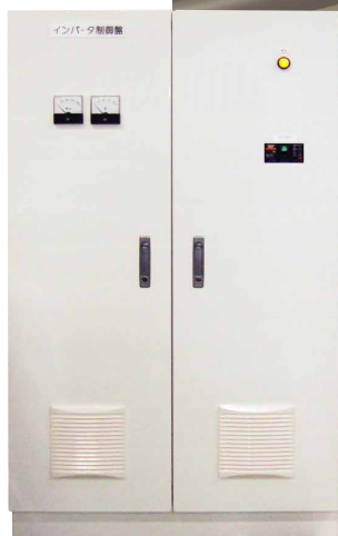
インバータ制御盤
