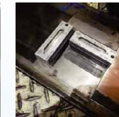
フレームレベル 確認、調整(OP)
